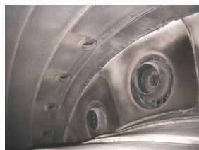
ガスタービン燃焼管
